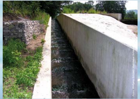
Borstenfischpass an der Wasserkraftanlage Camburg/Döbritschen
